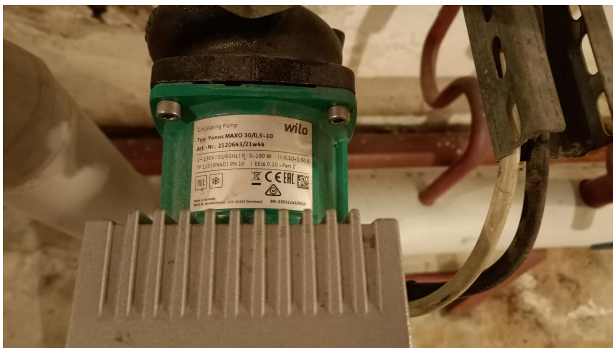
2.2 Pompa na powrocie instalacji ciepła technologicznego.
