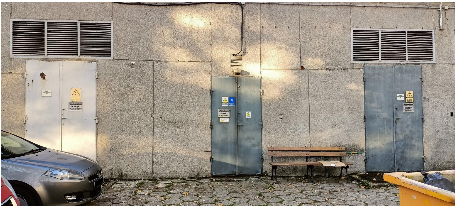
Zdj. 1. Drzwi wejściowe do rozdzielni głównej NN (środkowe) i komór transformatorowych (z lewej i prawej) wraz z fragmentem placu dojazdowego.
