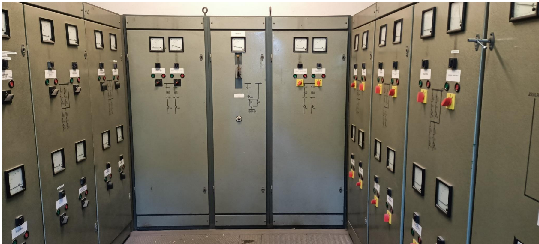
Zdj. 2. Widok ogólny rozdzielni głównej NN.
