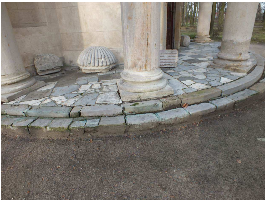
Fot.22 Stan posadzki przy wejściu tylnym.
