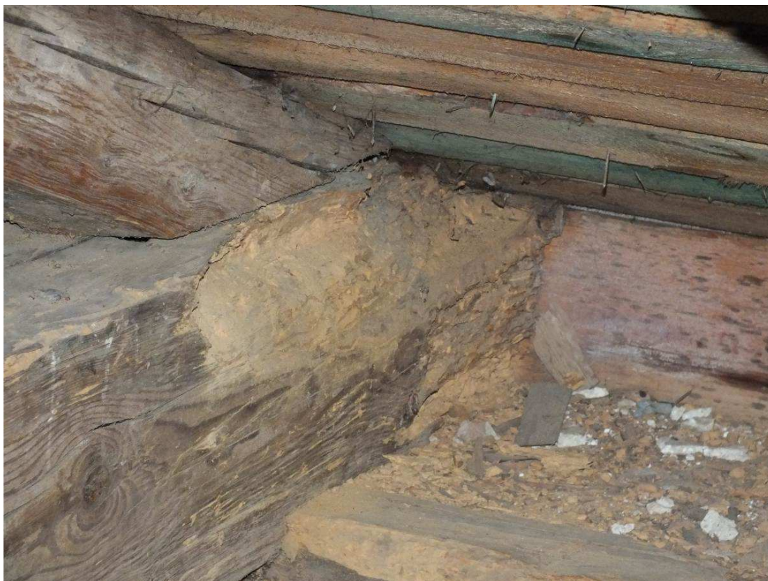
Fot.32 Uszkodzenie belki na skutek żerowania drewnojada.
