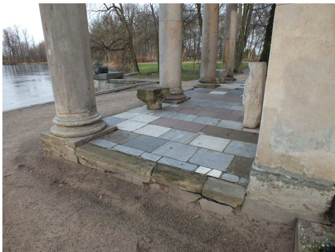
Fot.23 Stan warstw posadzkowych przy wejściu głównym.
