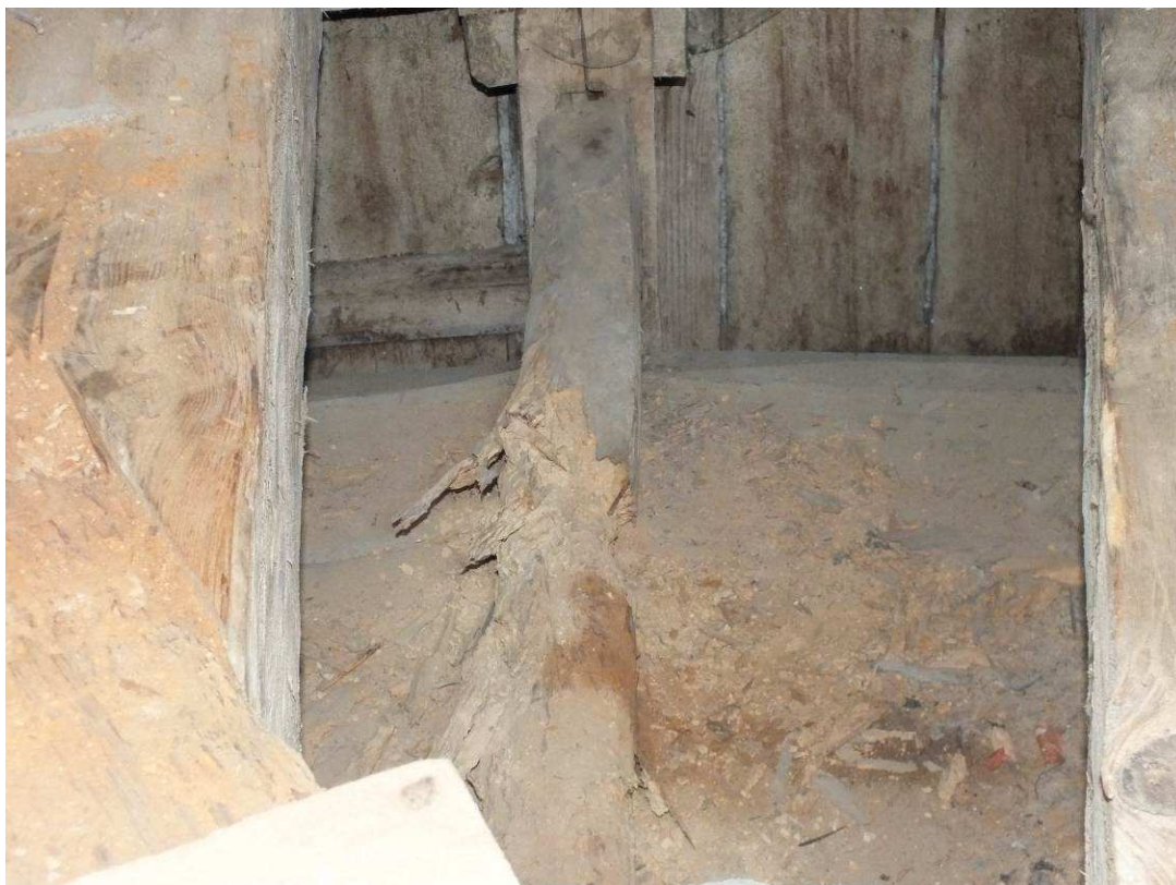
Fot.34 Uszkodzenie belki na skutek żerowania drewnojada.
