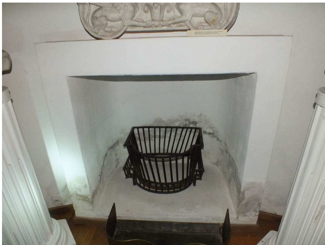
Fot.39 Zawilgocenie i zasolenie widoczne w przypodłogowej części ściany zewnętrznej.
