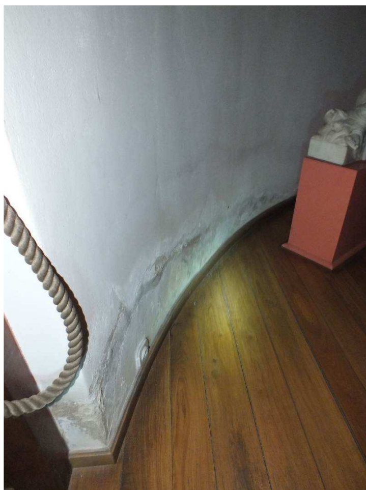
Fot.41 Zawilgocenie i zasolenie widoczne w przypodłogowej części ściany wewnętrznej.
