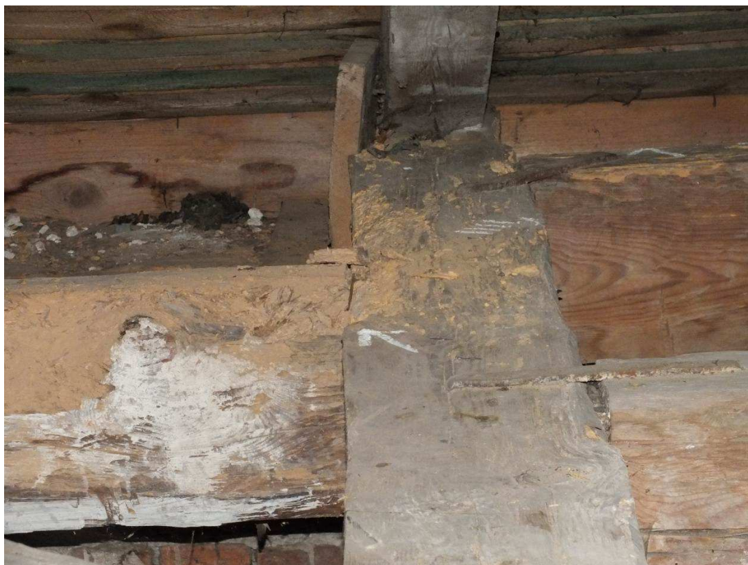
Fot.31 Uszkodzenie belki na skutek żerowania drewnojada.
