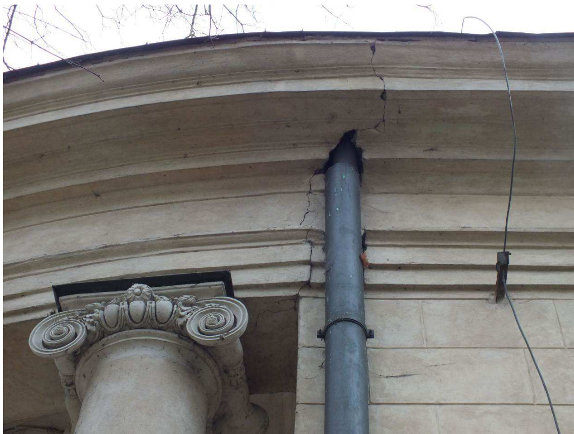
Fot.24 Zarysowanie gzymsu.
