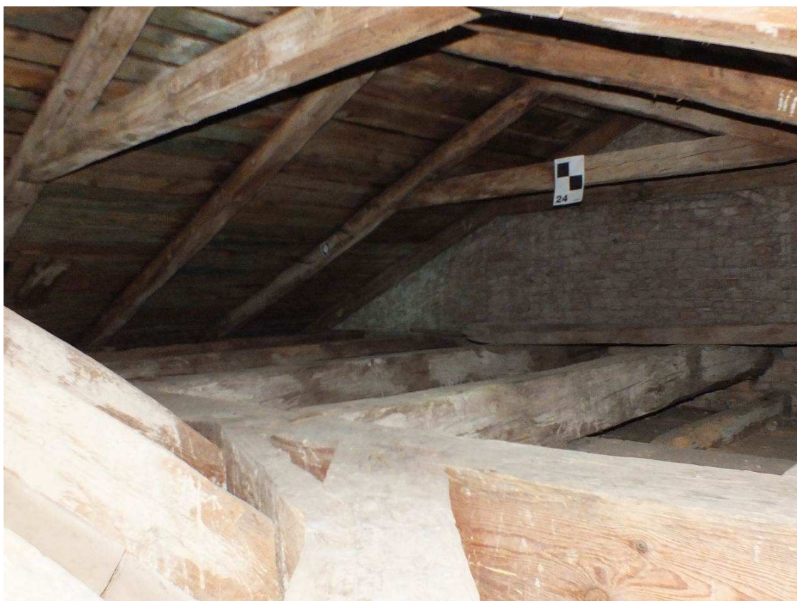
Fot.29 Widoczny brak jętki w trzecim więźarze – uszkodzenie czopów mocujących jętkę.
