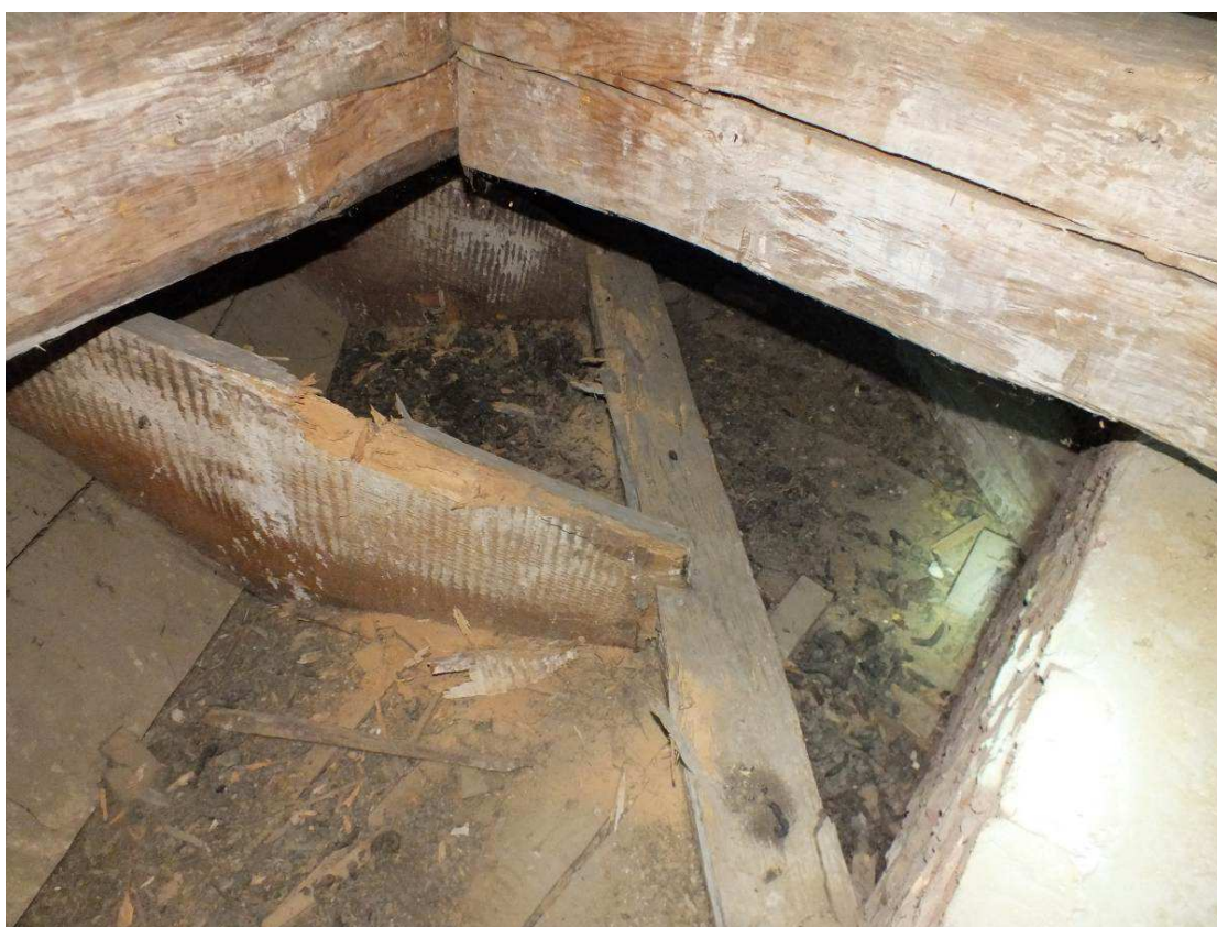
Fot.33 Uszkodzenie belki na skutek żerowania drewnojada.
