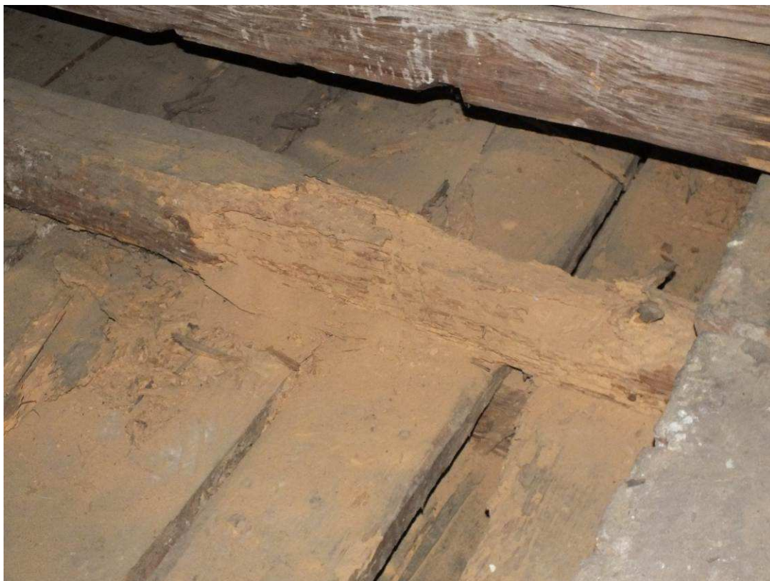
Fot.30 Uszkodzenie belki na skutek żerowania drewnojada.
