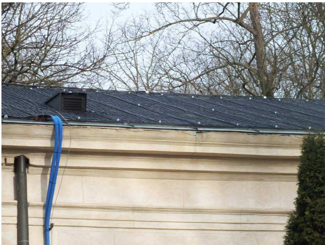
Fot.38 Ogrzewanie elektryczne połaci dachowej – doraźny sposób zabezpieczenia przed wzrostem ugięć konstrukcji więźby dachowej na skutek opadów śniegu.
