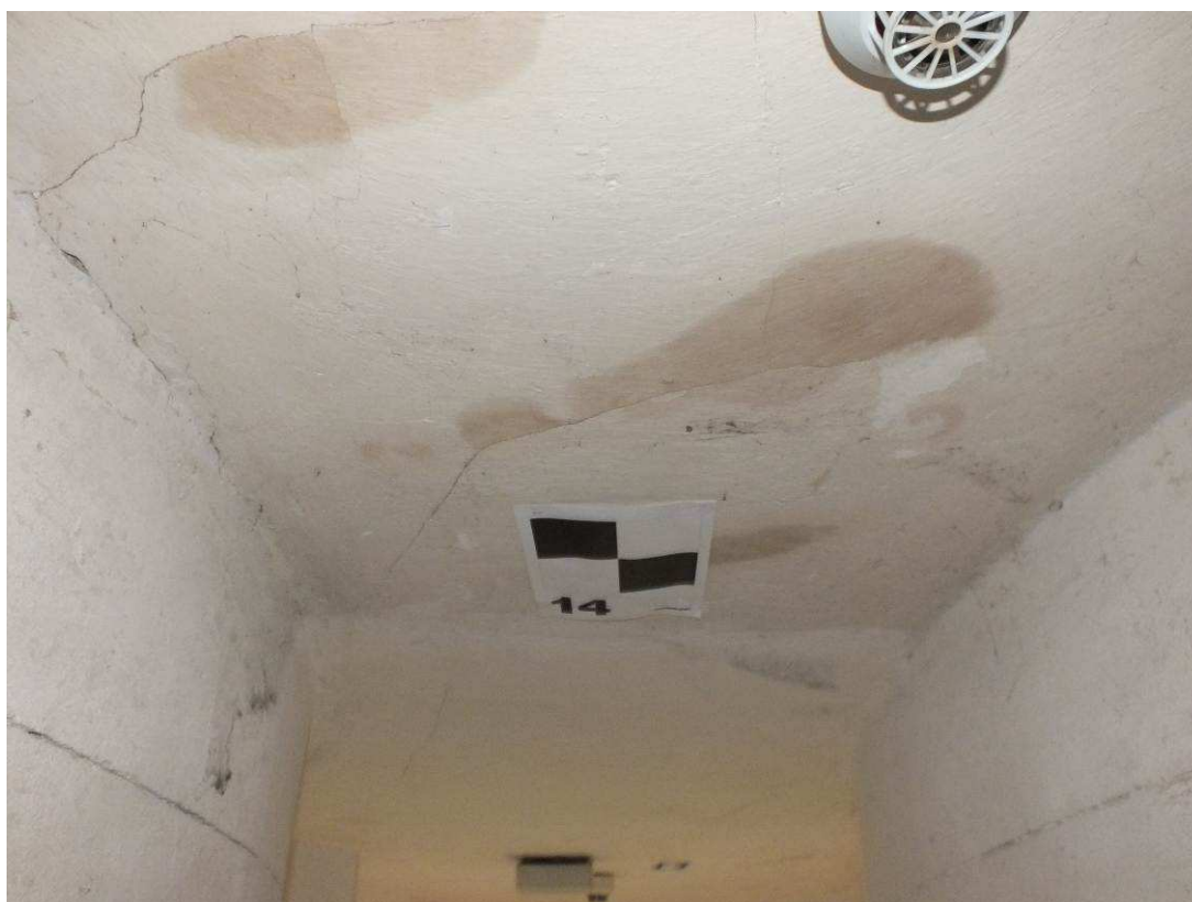
Fot.35 Plamy zawilgoceń oraz zarysowania wodoczne na tynku sufitowym.
