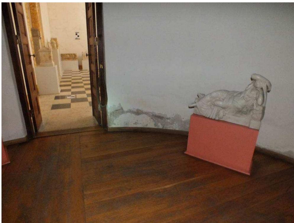
Fot.40 Zawilgocenie i zasolenie widoczne w przypodłogowej części ściany wewnętrznej.
