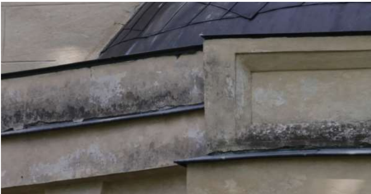
Fot. 36. Strona S. elewacja wykuszu sypialni. Naczótek. Wykruszenia tynku wzdłuż obróbek blacharskich spowodowane brakiem wydry. Strefa postępującej degradacji tynków. Efektem silnego zawilgocenia jest wzmożony rozwój flory (porosty) i destrukcja warstw powierzchniowych (sole, szkody mrozowe).
