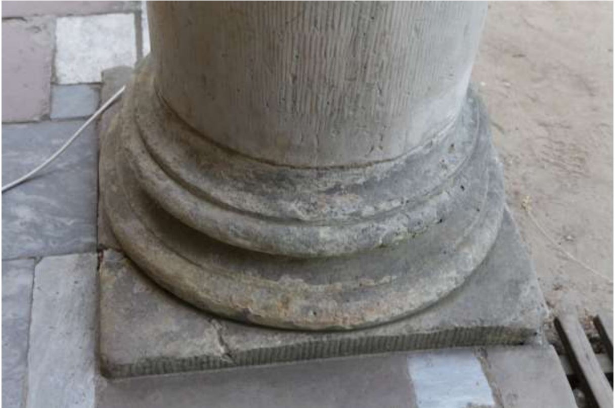
Fot. 70. Portyk W. Baza kolumny. Uszkodzenia mechaniczne i strukturalne kamienia. Zawilgocenie spowodowane podsiąkaniem – okładziny kamienne tarasu popękane, spoiny zniszczone. Brak prawidłowego odpływu wody.
