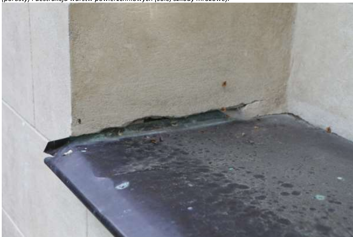
Fot. 38. Elewacja, strona S. Parapet wneki na ścianie kominkowej Sypialni Owalnej. Obróbka blacharska parapetu. W zaprawie nie wyprofilowano wydry, co skutkuje pękaniem i wykruszaniem się tynku.
