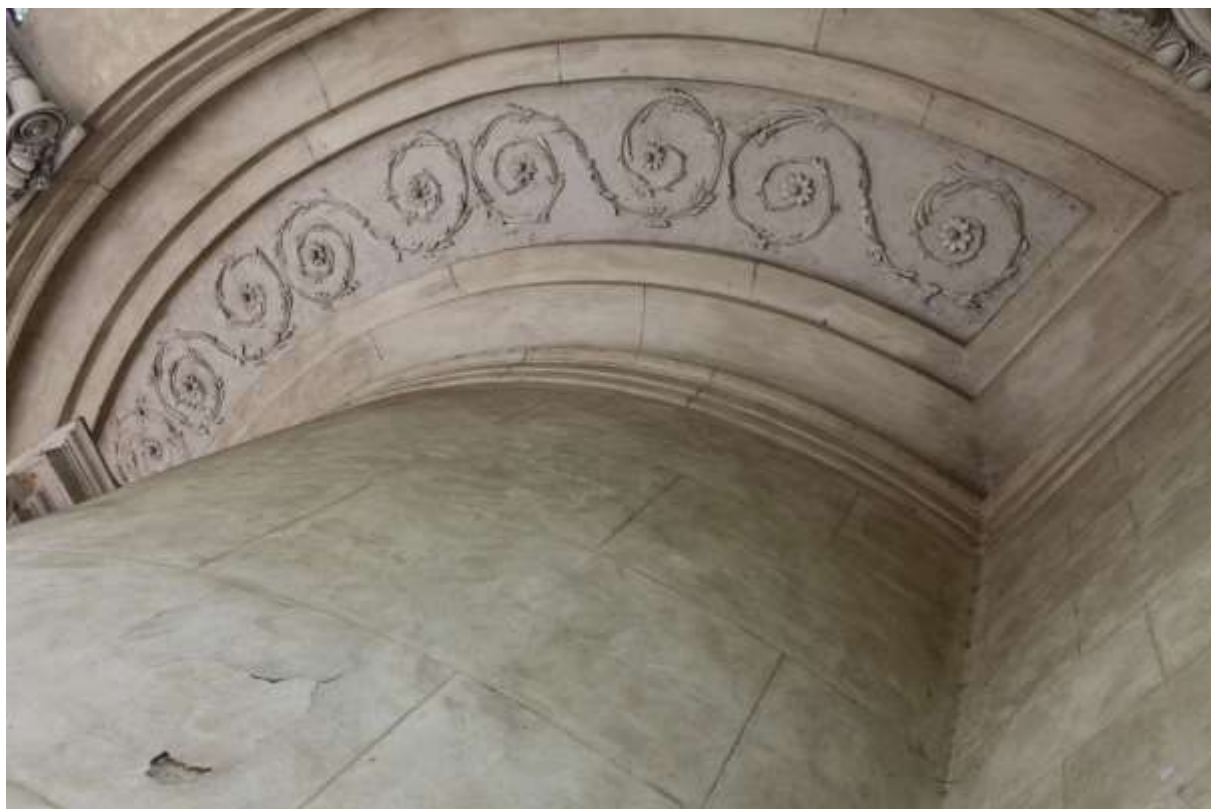
Fot. 57. Detal sztukatorski na podniebiu portyku E. Stan dobry. Tynki posiadają charakterystyczne uszkodzenia.
