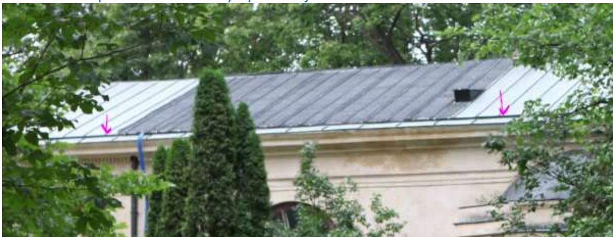
Fot. 26. Istniejący system odprowadzenia wody z dachu. Zrzut wody do rur spustowych odbywa się przez kierowanie jej przez wyprofilowaną w blasze stójkę (zastawę)(oznaczenie strzałkami).
