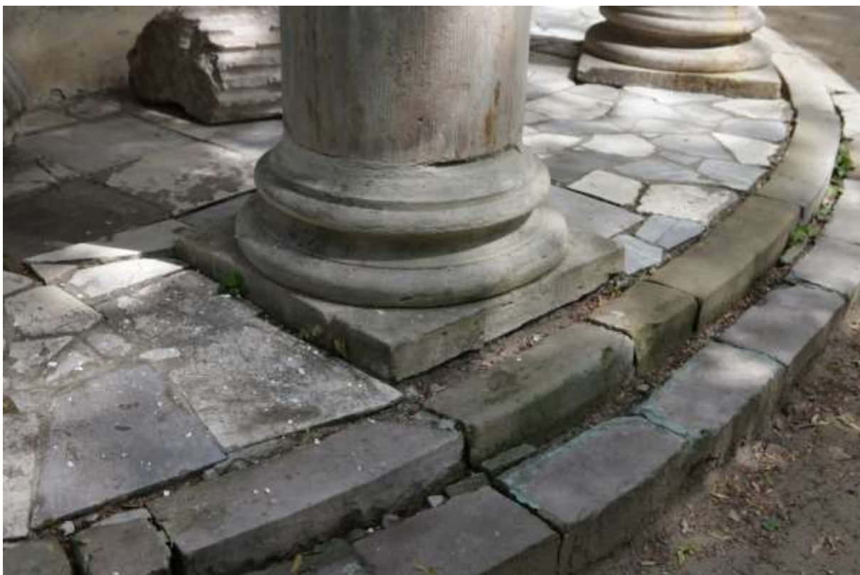
Fot. 68. Portyk E. Strona E. Baza kolumny. Obramienie i posadzka tarasu. . Szkody spowodowane przez zjawiska wysadzin związanych z przemarzaniem gruntu.
