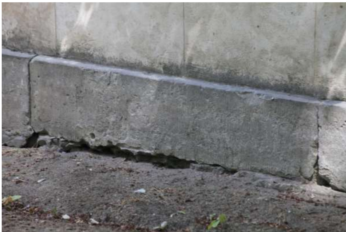
Fot. 44. Strona SE, Kamienny cokół podmyty. Ubytki w podlewce, Wyraźna powierzchniowa dezintegracja strukturalna kamienia. Spoina pomiędzy kamieniem i tynkiem wypełniona zaprawą cementową.
