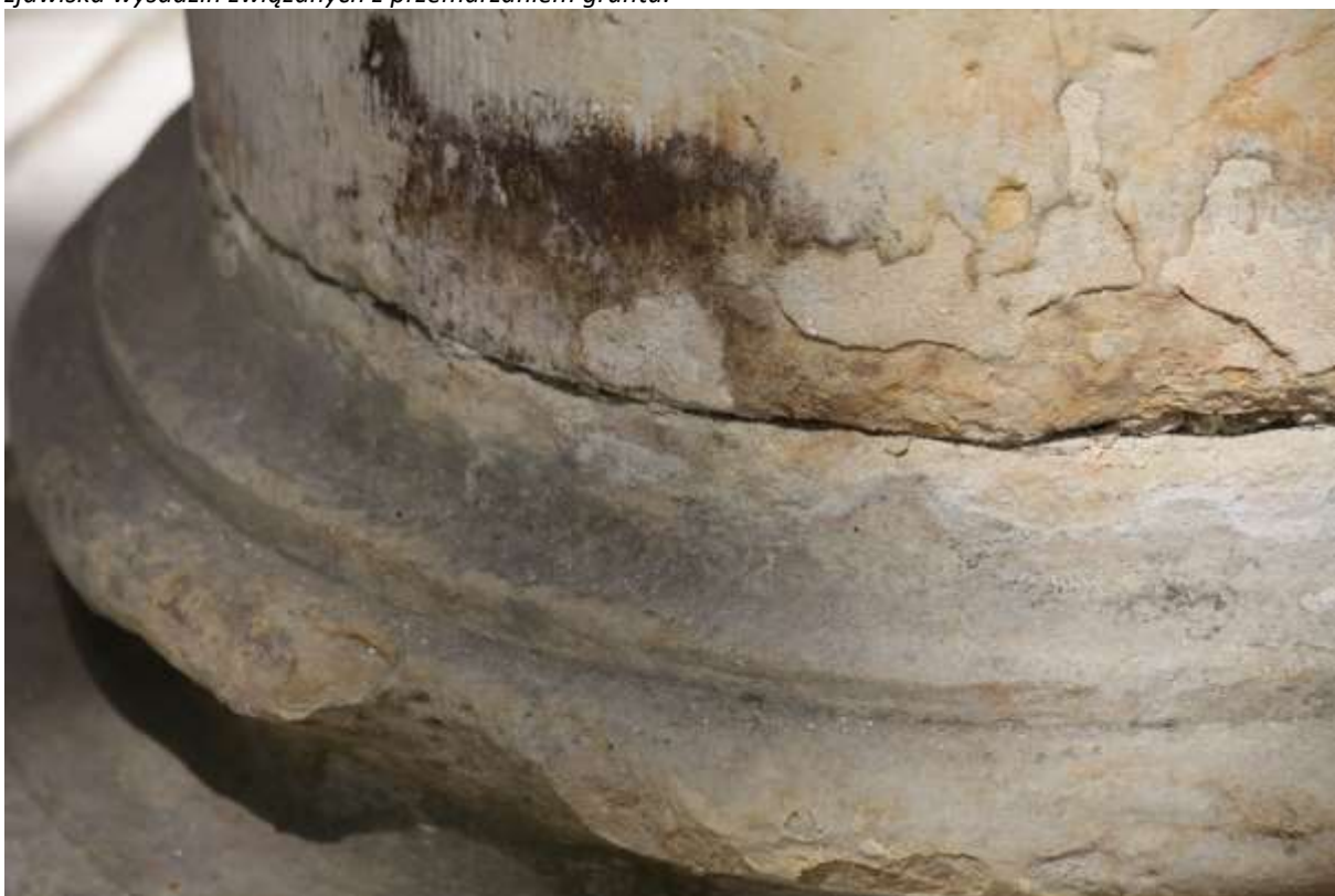
Fot. 69. Portyk E. Baza kolumny. Uszkodzenia mechaniczne i strukturalne kamienia. Zawilgocenie spowodowane podciąganiem – okładziny kamienne tarasu popękane, spoiny zniszczone. Brak prawidłowego odpływu wody.
