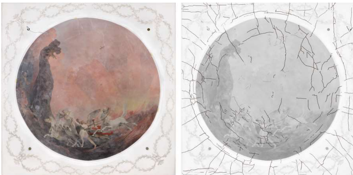
Fot. 85. Inwentaryzacja rysunkowa spękań plafonu „Jutrzenka”. Zarejestrowano spękania plafonu widoczne i słabo widoczne na powierzchni malowidła i sztukaterii
