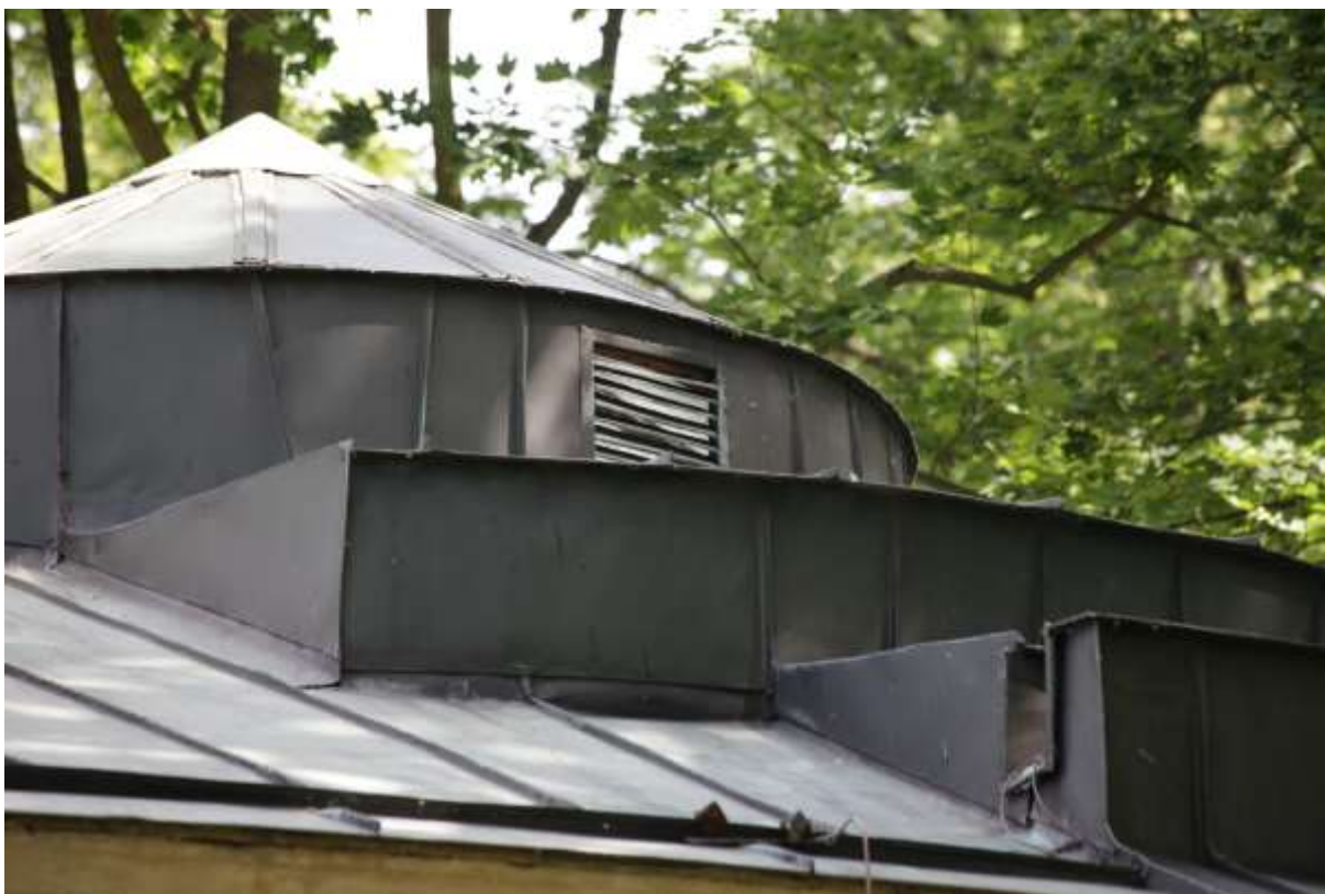
Fot. 32. Obróbki blacharskie świetlika.
