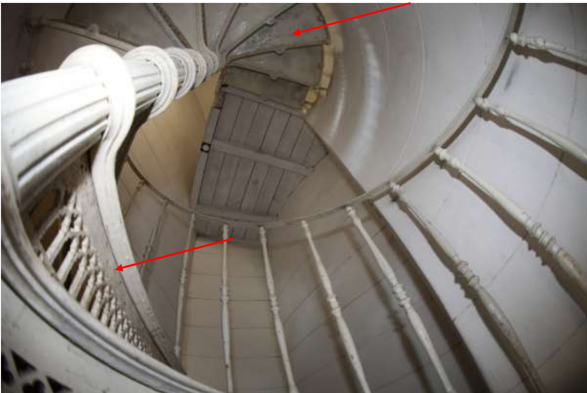
Fot. 125. Schody żeliwne. Liczne drobne uszkodzenia powłoki malarskiej. Brud i kurz w połączeniu z wilgocą powodują, że na chłodnej powierzchni (malowany metal) pojawiają się kolonie pleśniowe.
