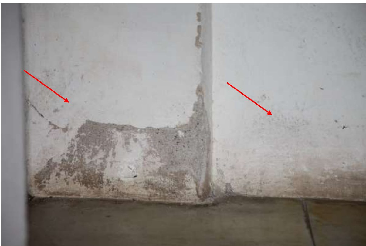
Fot. 119. Westybul Zawilgocenie strefy przyposadzkowej. Na ścianie widoczne szare naloty pleśniowe.
