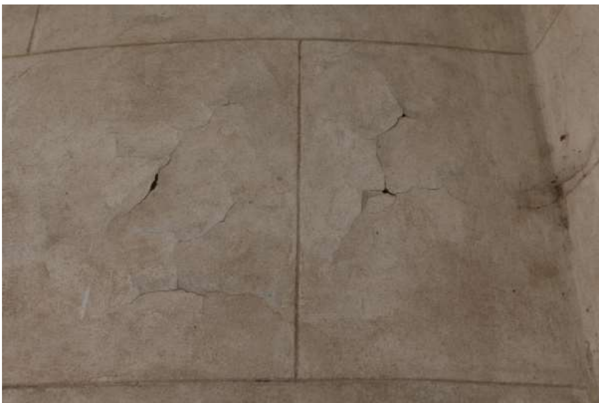
Fot. 56. Uszkodzenia tynku – strona E.
