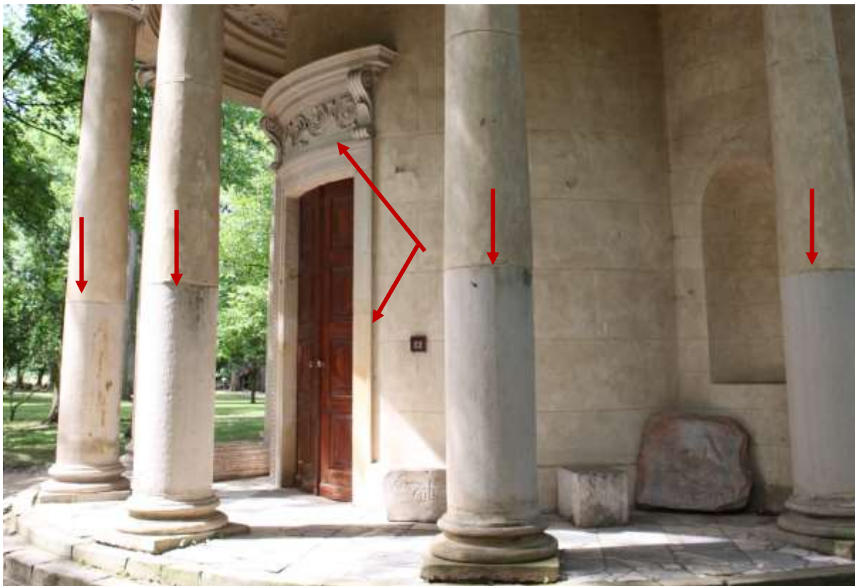
Fot. 66. Portyk E. Strzałkami oznaczono elementy z piaskowca (bazy i dolne części trzonów, portal).
