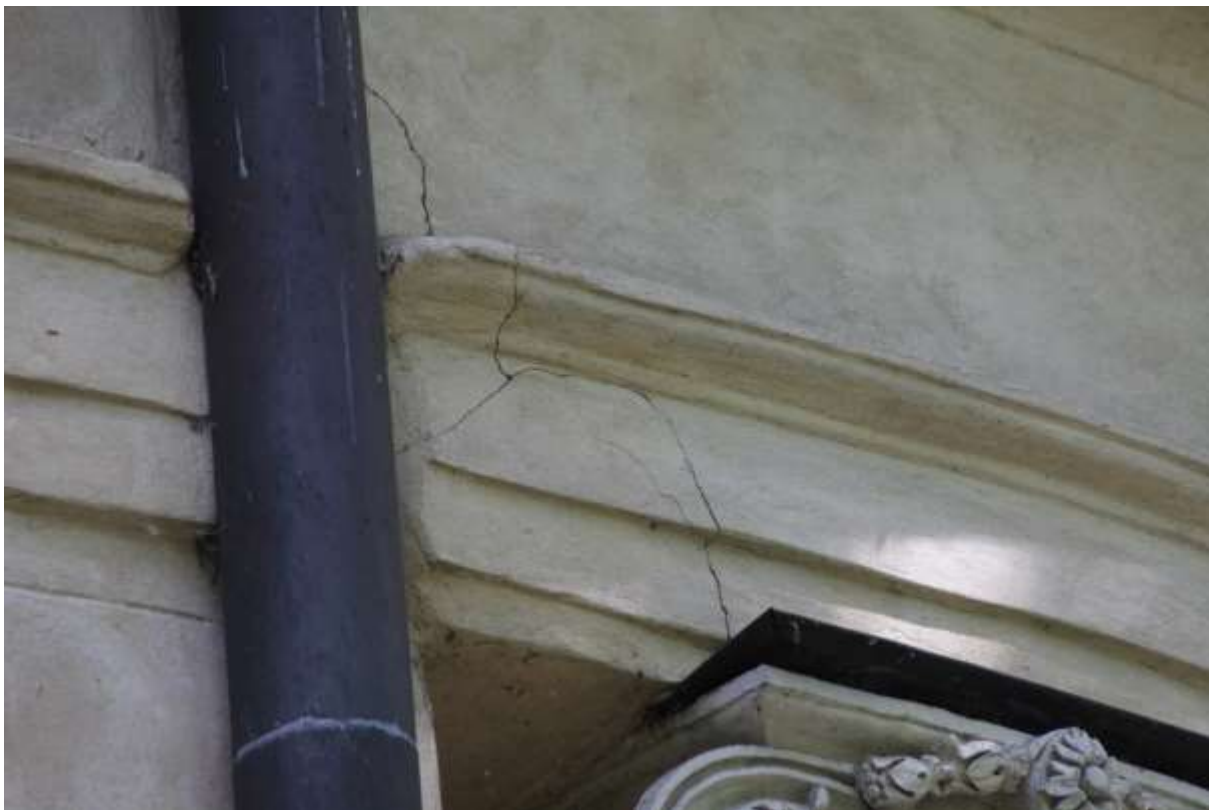
Fot. 65. Pęknięcia na fryzie od strony SE.
