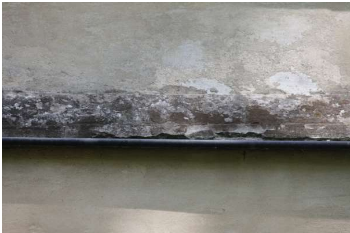
Fot. 37. Strona S. elewacja wykusza sypialni. Naczótek. Wykruszenia tynku wzdłuż obróbek blacharskich Strona S. elewacja wykuszu sypialni. Uszkodzenia tynku nad obróbką spowodowane brakiem wydry: rozwój flory (porosty) i destrukcja warstw powierzchniowych (sole, szkody mrozowe).
