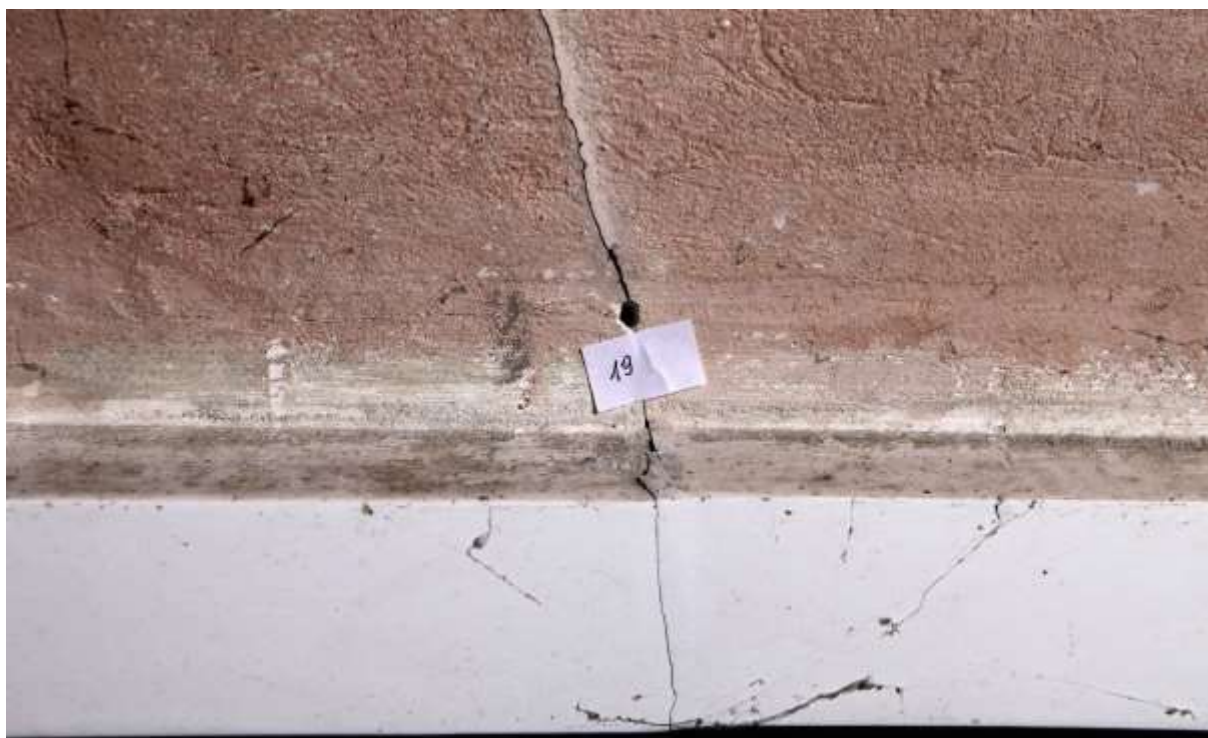
Fot. 89. Pęknięcie przechodzące przez tambur. Widoczne zarysowanie biegnące wzdłuż wtórnego wypełnienia szczeliny.
