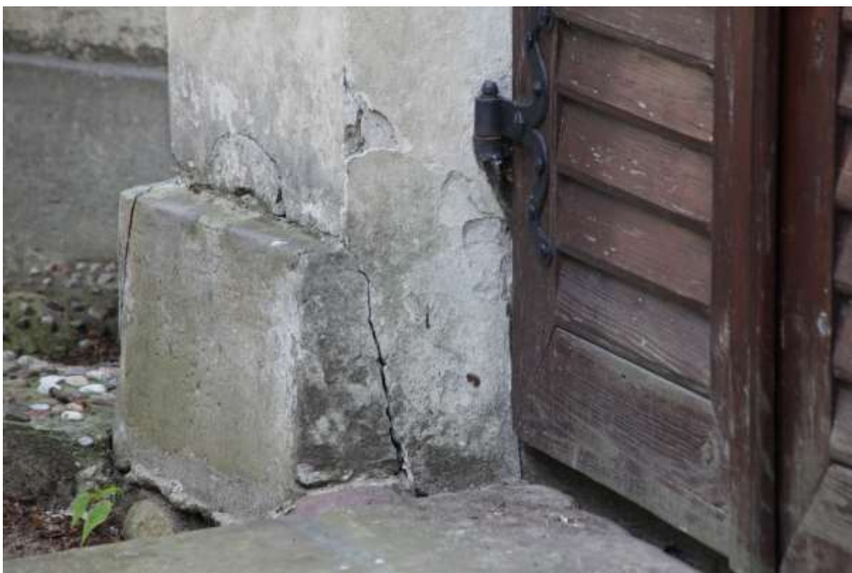
Fot. 43. Szkody wysadzinowe w obrebie cokołu przy wejści od strony SW do Sypialni Owальной. Cokół odspojony. Szkody spowodowane zawilgoceniem: dezintegracja i tuszczanie się tynku.
