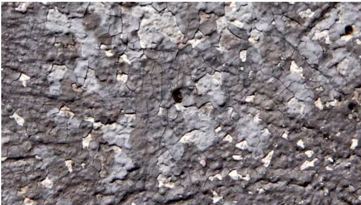
Fot. 92. Warstwa malarska – zbliżenie. Spękania, ubytki i retusze.
