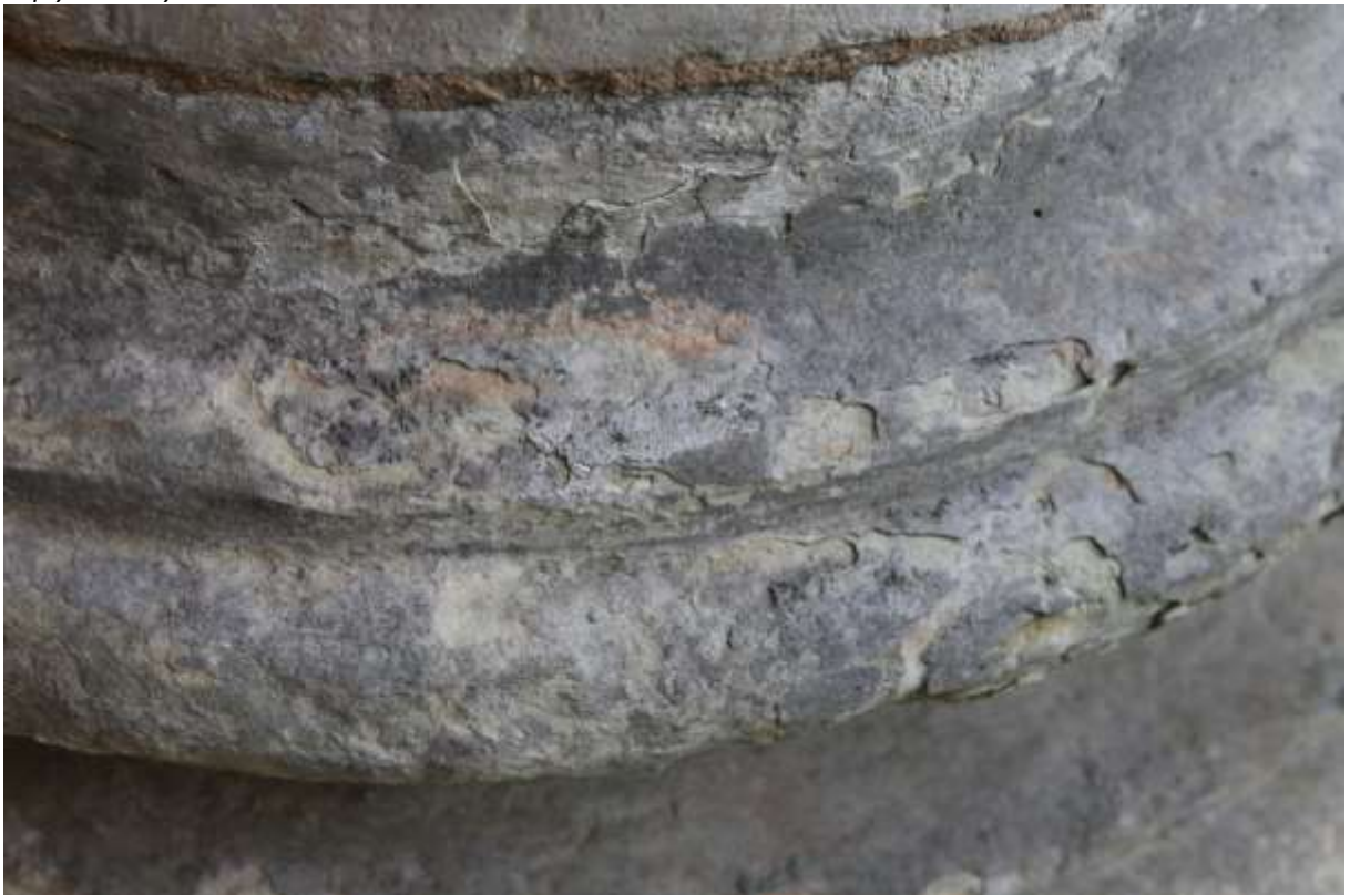
Fot. 71. Zbliżenie. Widoczna dezintegracja struktury kamienia. Delaminacja warstw wierzchnich.
