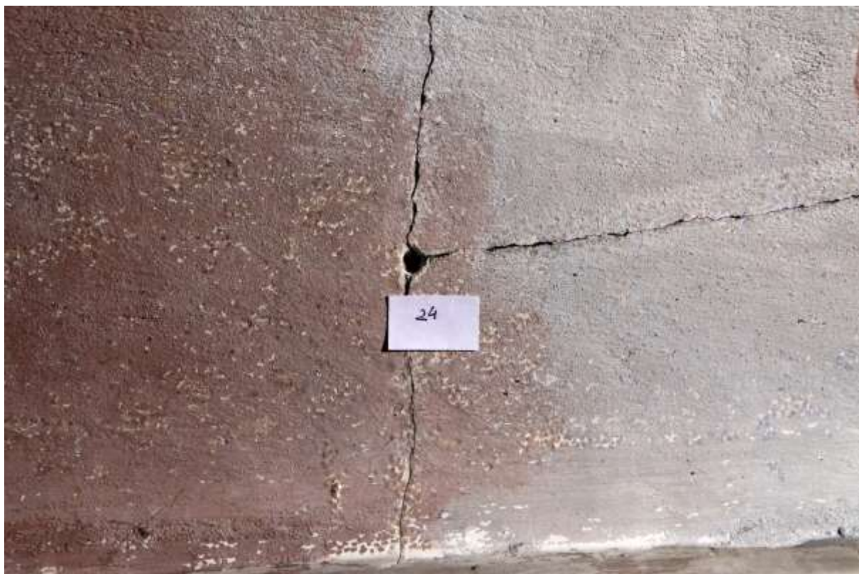
Fot. 90. Styk pęknięć - wertykalnego (wzdłuż krążyny) i obwodowego). Dłone wykruszenia wstwy malarskiej i zmiany kolorystyczne retusze.
