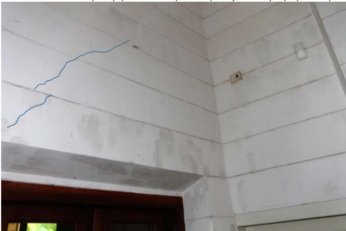
Fot. 123. Ślady poprawek malarskich w postaci ciemnych smug. Na fotografii oznaczono wyraźne pęknięcia nadproża drzwi prowadzących do gabinetu Etruskiego.
