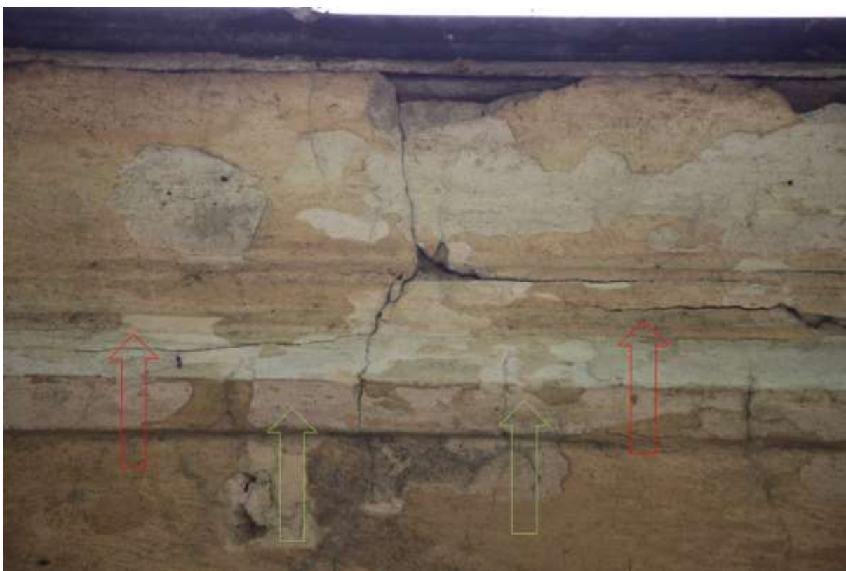
Fot. 60. Strona S – gzyms; pod żółtą ziarnistą przecierką widoczne wcześniejsze opracowania powierzchni – gładza warstwa ugrowa i warstwa różowa. Brak dylatacji pomiędzy deskowaniem poszycia a gzymsem .
