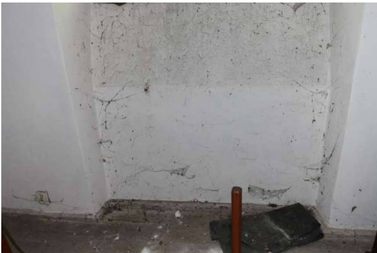
Fot. 131. Ściana podokienna w pokoju na poddaszu.
