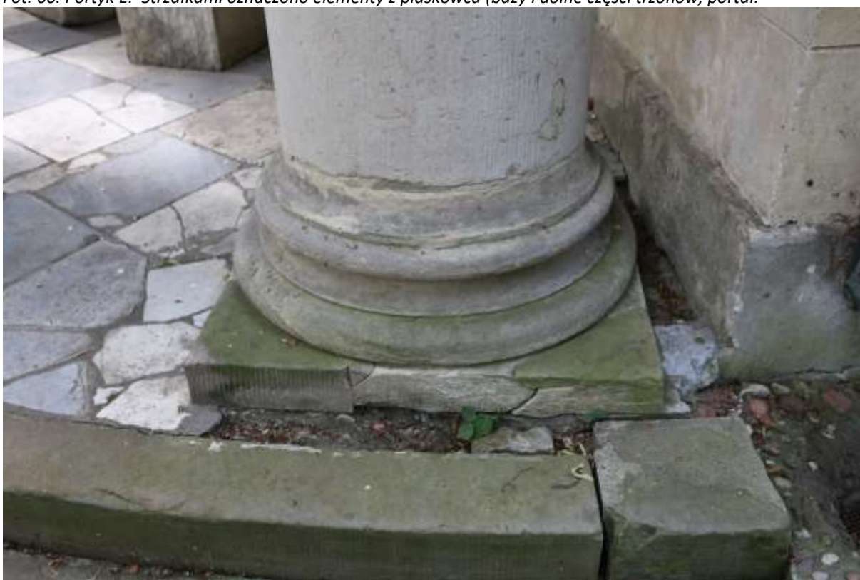
Fot. 67. Portyk E. Strona N. Baza kolumny. Obramienie i posadzka tarasu. Szkody spowodowane przez zjawiska wysadzin związanych z przemarzaniem gruntu.
