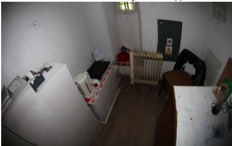
Fot. 111. Służbówka. Pomieszczenie zawilgocone. Naloty pleśniowe na ścianie ptn.
