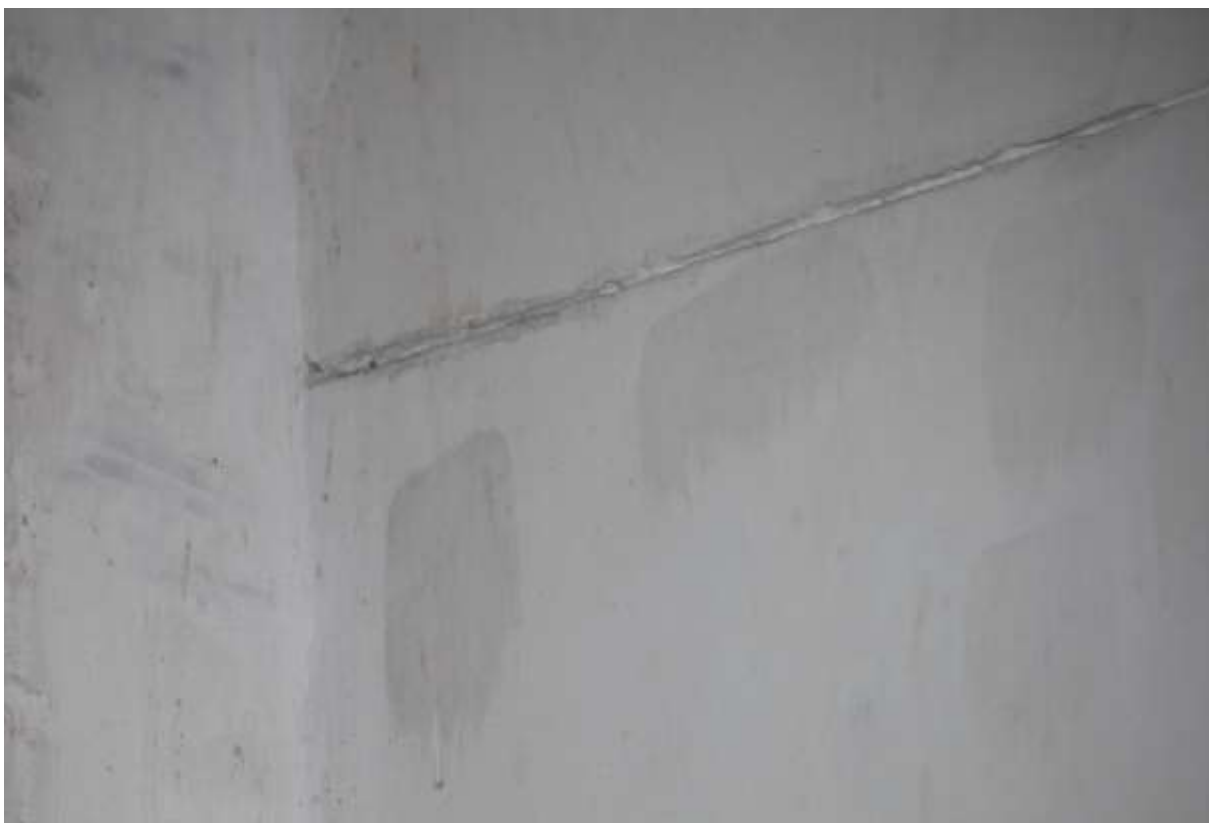
Fot. 117. Pociemniałe poprawki malarskie (farba lateksowa ?, poliwinylowa ? lub akryl ?). Niestaranne opracowanie podziału na ciosy (wykruszenia krawędzi).
