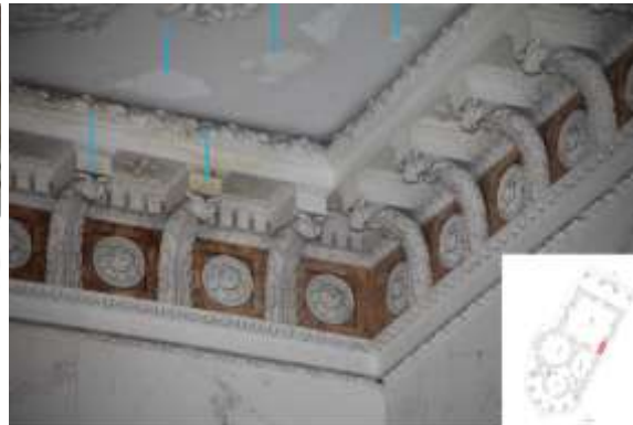
Fot. 29. Wnętrze. Narożnik NE Panteonu – widoczne zniszczenia spowodowane zaciekaniem wody opadowej.
