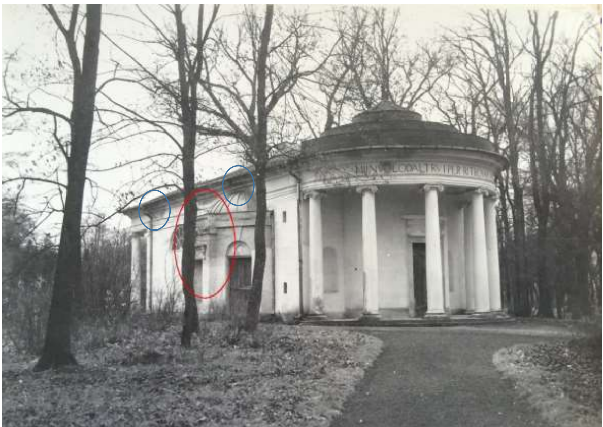
Fot. 22. Przed 1939 (lata 20. ??). Widoczne zacieki i uszkodzenia na gzymsie i fryzie oraz wykuszu sypialni owalnej. Doskonale czytelny napis na fryzie wschodnim. Fot. przedwojenna z dokumentacji PKZ IMG 2278
