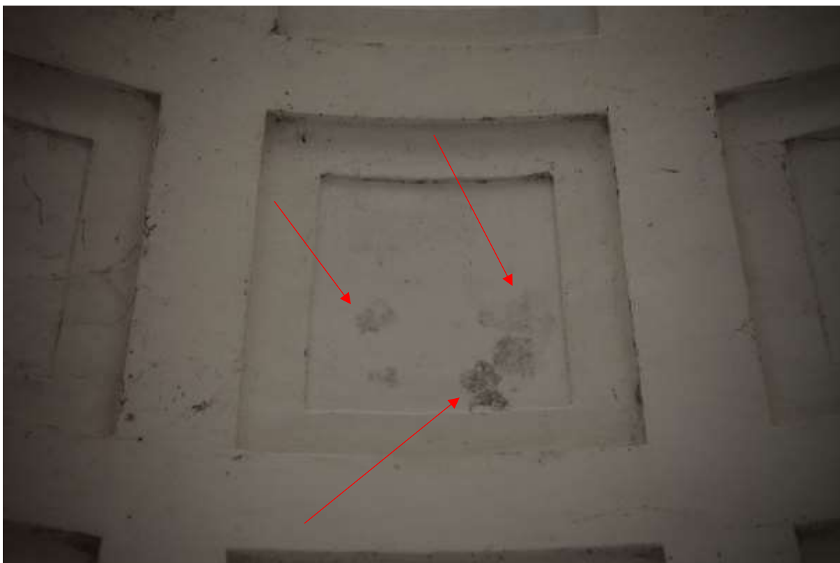
Fot. 114. Westybul. Kupuła. Powierzchnia pokryta kurzem i pajęczynami. Widoczny miejscowy intensywny rozwój koloni pleśniowych, co wskazuje na złe warunki mikroklimatu wnętrza (niedostateczne wentrowienie, kondensacja pary wodnej na wychłodzonych powierzchniach).
