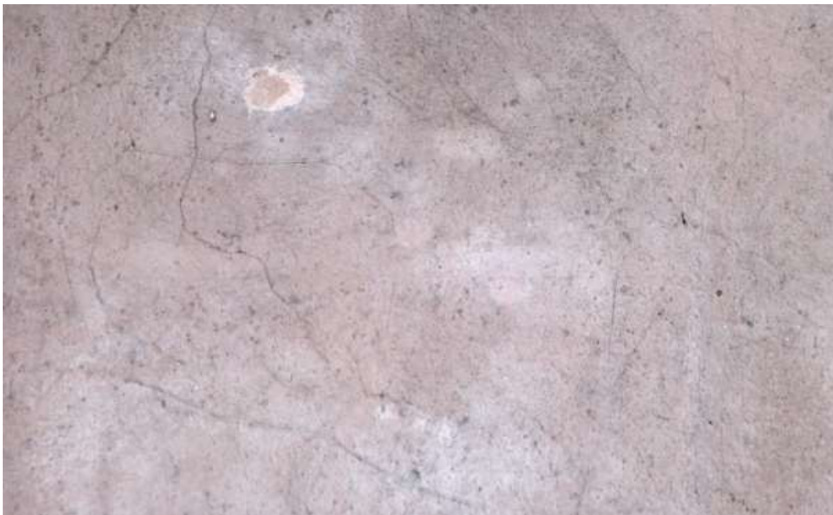
Fot. 104. Owalna Sypialnia, Plafon - fragment. Spękania (pierwotne), zabrudzenia i zmiany kolorystyczne retuszy
