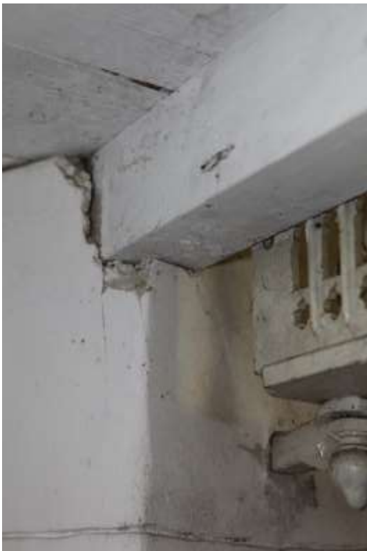
Fot. 127. Uszkodzenia tynku przy belkowaniu stropu – brak dylatacji. Naloty pleśniowe na powale i belce.
