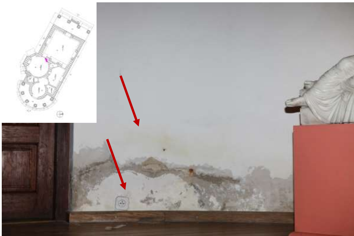
Fot. 106. Owalna Sypialni, Strefa bardzo silnego zawilgocenia i zasolenia. Rozwój pleśni na powierzchni. Uwaga : ściana wewnętrzna budynku !
