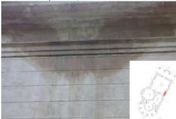
Fot. 28. Strona N: zaciek na zewnątrz widoczny w postaci leja
