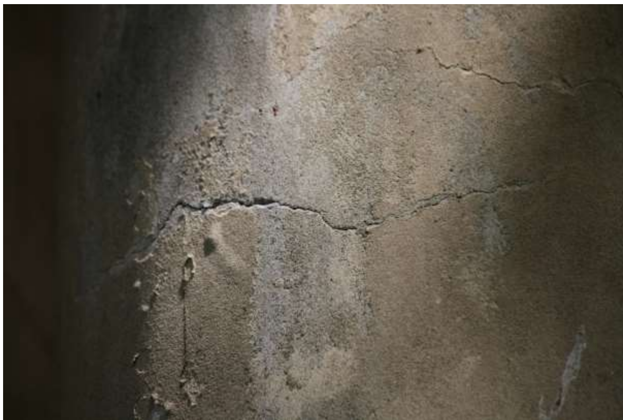
Fot. 54. Portyk wschodni. Trzon kolumny – partia tynkowana. Uszkodzenia wyprawy tynkarskiej. Głębokie pęknięcie wyprawy. Degradacja i odspojenie wierzchniej, żółtej przecierki. .
