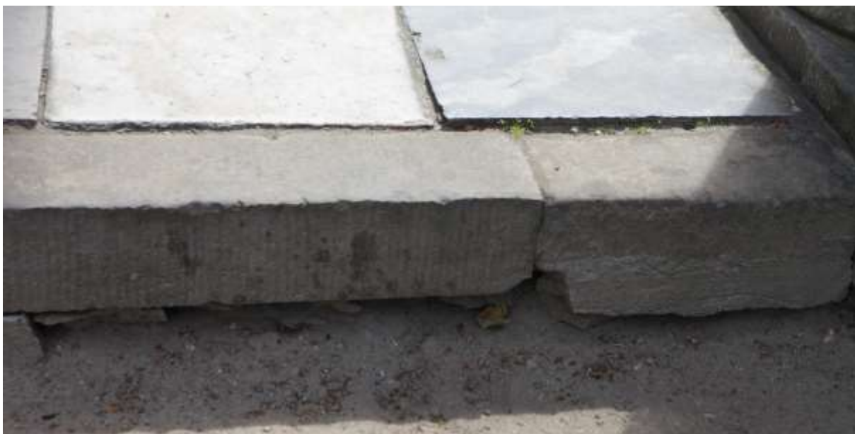
Fot. 72. Taras pod portykiem W. Krawężnik i marmurowe płyty posadzki. Pod krawężnikiem wypłukany grunt.
