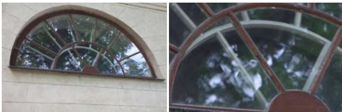
Fot. 80. Stolarka okienna – okno Panteonu, strona N. Wzdłuż obwodu ościeznicy szczelina i wykruszenia tynku.
