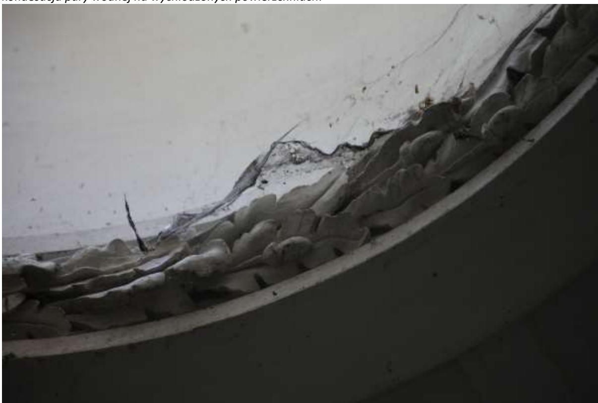
Fot. 115. Westybul. Tambur latarni. Zabrudzenia powierzchni. Pajęczyny.
