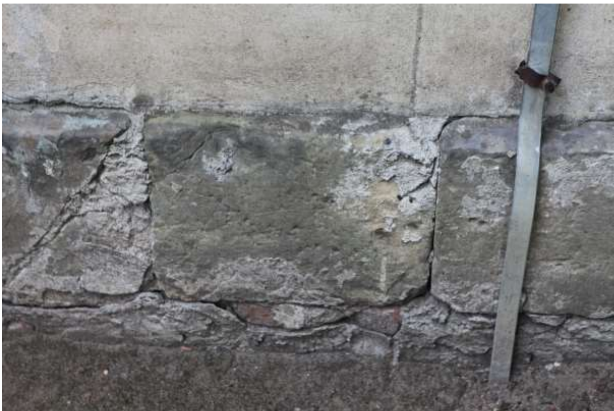
Fot. 73. Cokół kamienny od strony S. Uszkodzenia powierzchniowe i strukturalne. Naprawy cementowe,
