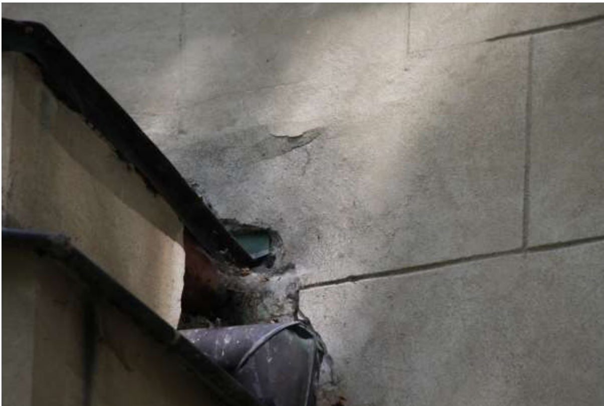
Fot. 35. Strona S. Zadaszenie nad sypialnią owalną. Obróbki blacharskie wpuszczone w tynk bez wydry. Pęknięcia i odspojenia na styku obróbek blacharskich z tynkami
