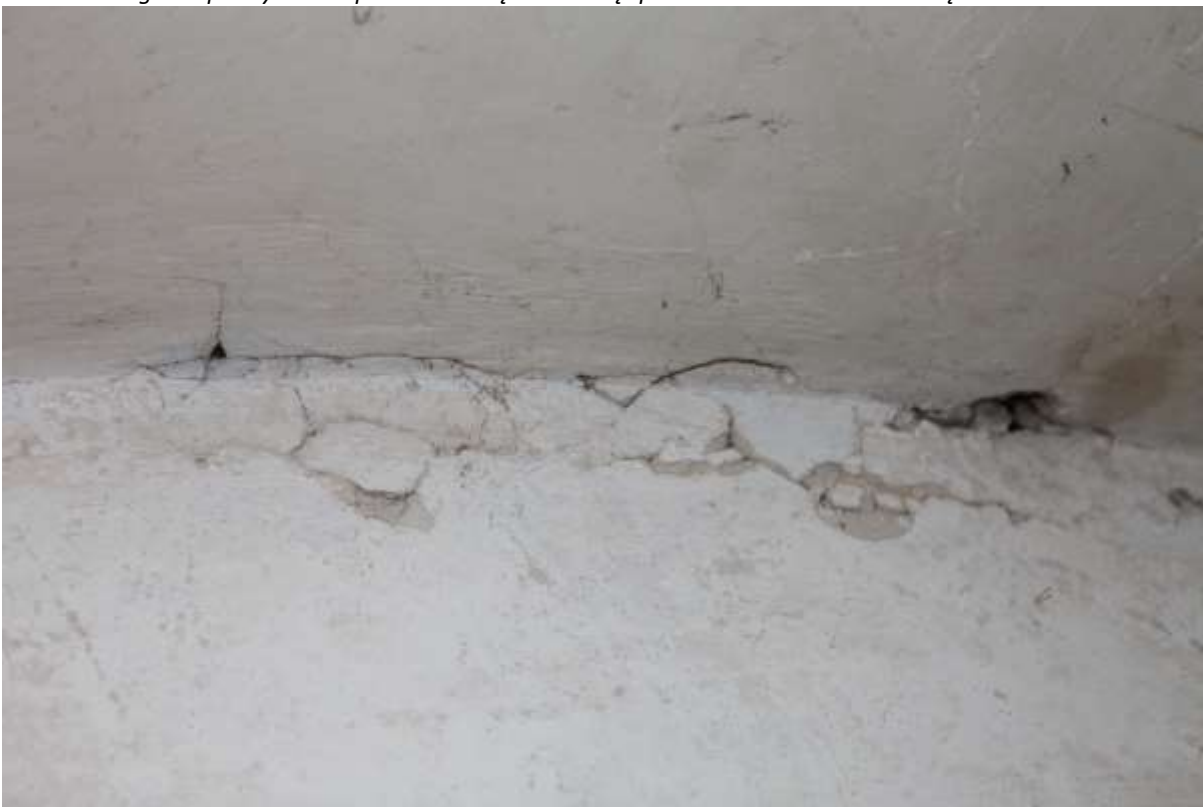
Fot. 130. Korytarz na piętrze. Na połączeniu ściany z powłoką pęknięcia i wykruszenia tynku. Ślady zawilgocenia.
