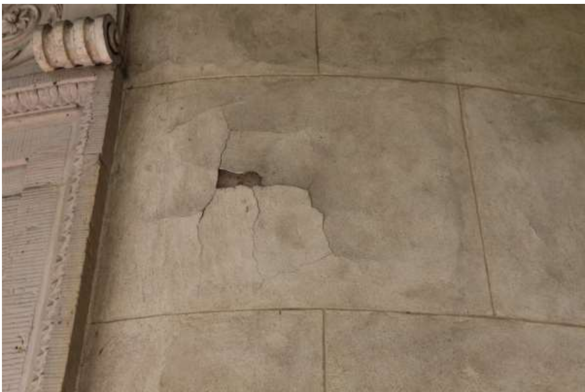
Fot. 55. Tynki – strona E. Odparzenia i spękania.
