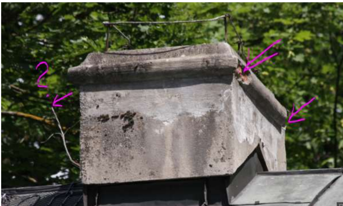
Fot. 39. Uszkodzenia komina. Ubytki w wałku. Należy sprawdzić stan instalacji odgromowej – na zdjęciu widoczna luźna końcówka przewodu.
