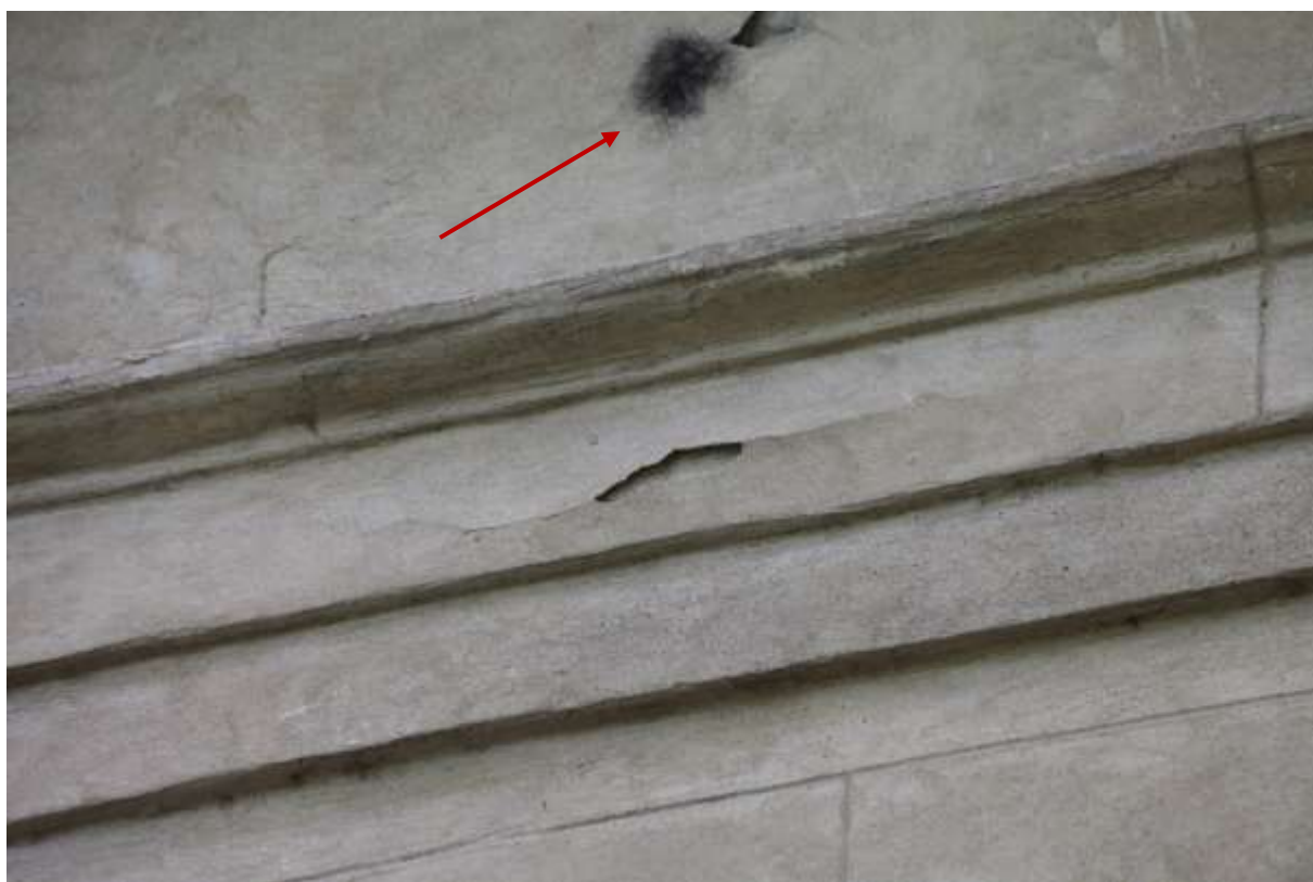
Fot. 62. Uszkodzenia tynku – strona S. Pas pod gzymsem. Strzałka oznaczono miejsce silnego zagrzybienia wewnątrz odspojenia tynku, widoczne na zewnątrz w postaci czarnego przebrawienia.
