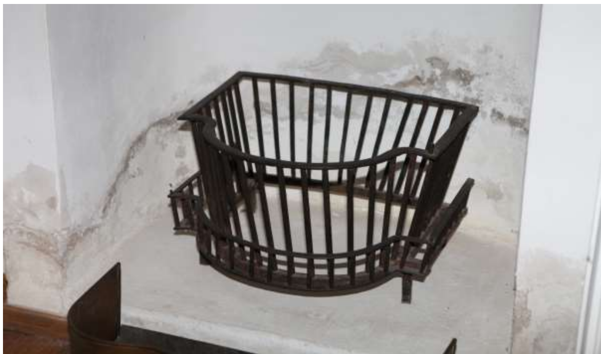
Fot. 40. Owalna Sypialnia, Kominek. Strefa zawilgocenia i wysoleń
