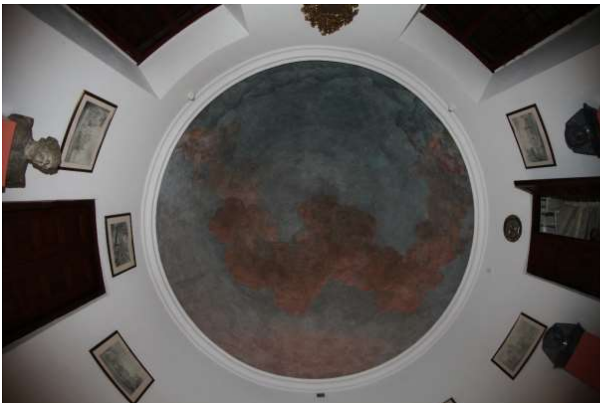
Fot. 99. Owalna Sypialnia, widok ogólny na plafon. Plafon -stan dość dobry. Zmienione retusze. Powierzchniowe zabrudzenia. Weryfikacja stanu możliwa po uzyskaniu bezpośredniego dostępu do powierzchni.
