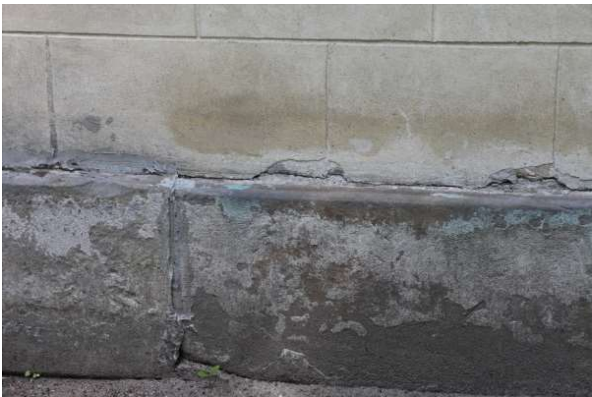
Fot. 42 Strona SE, Kamienny cokół pokrywają pozostałości wtórnych przecierak zakrywających reflowanie kamienia. Uwagę zwracają cementowe, niestarannie założone spoiny. Wykruszenia na stku kamień-tynek.
