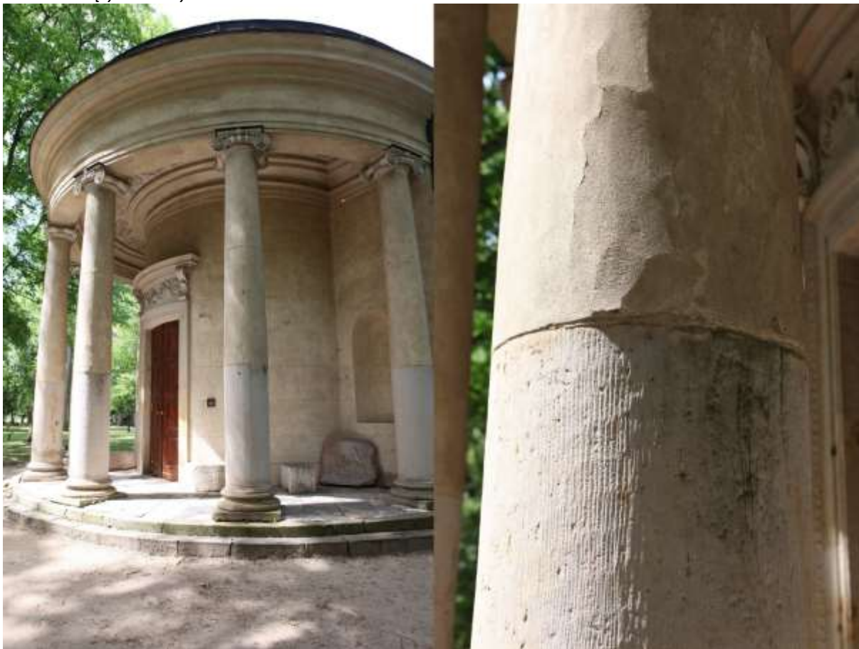
Fot. 52. Tynki – strona E. Partie odparzone, spękana i odspajające się.
