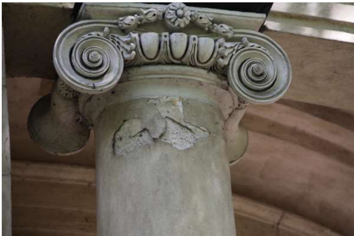
Fot. 53. Uszkodzony tynk na trzonie kolumny.
