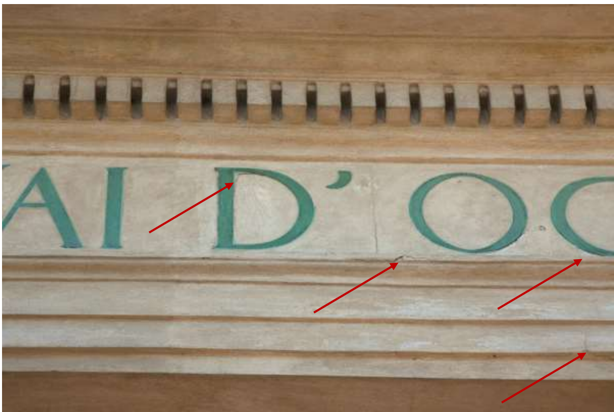
Fot. 63. Fryz nad portykiem strona W. Pas z inskrypcją. Uszkodzenia tynku. Strzałkami oznaczono miejsce odspojień.
