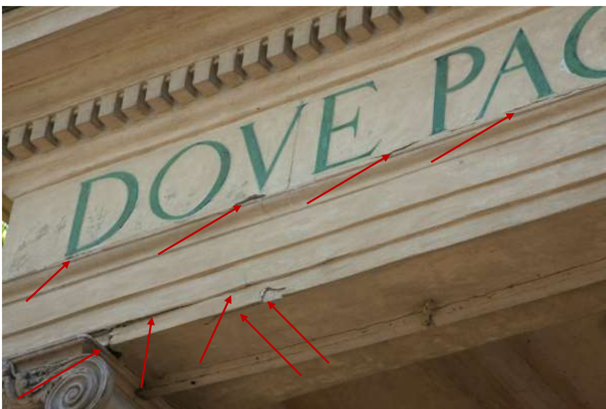
Fot. 64. Fryz nad portykiem strona W. Pas z inskrypcją. Strzałkami oznaczono miejsce odspojień i wykruszeń tynku.
