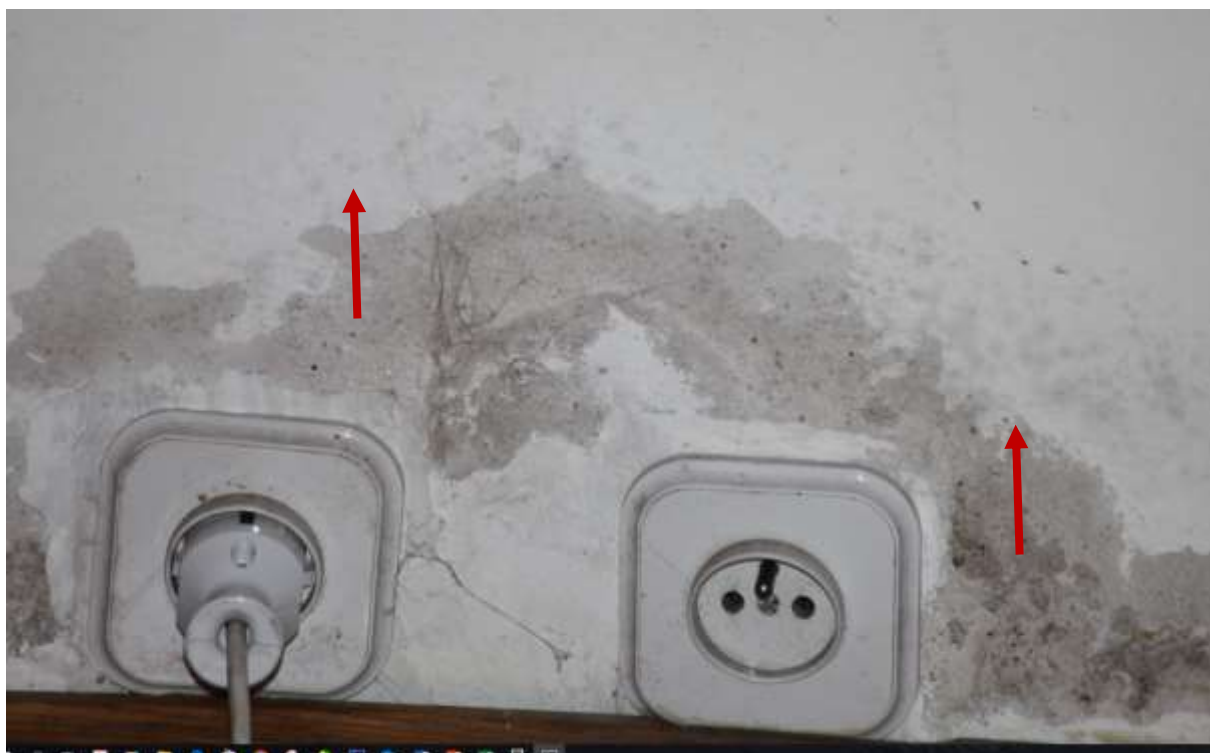
Fot. 107. Owalna Sypialnia, Strefa zawilgocenia i zasolenia. Rozwój pleśni na powierzchni
