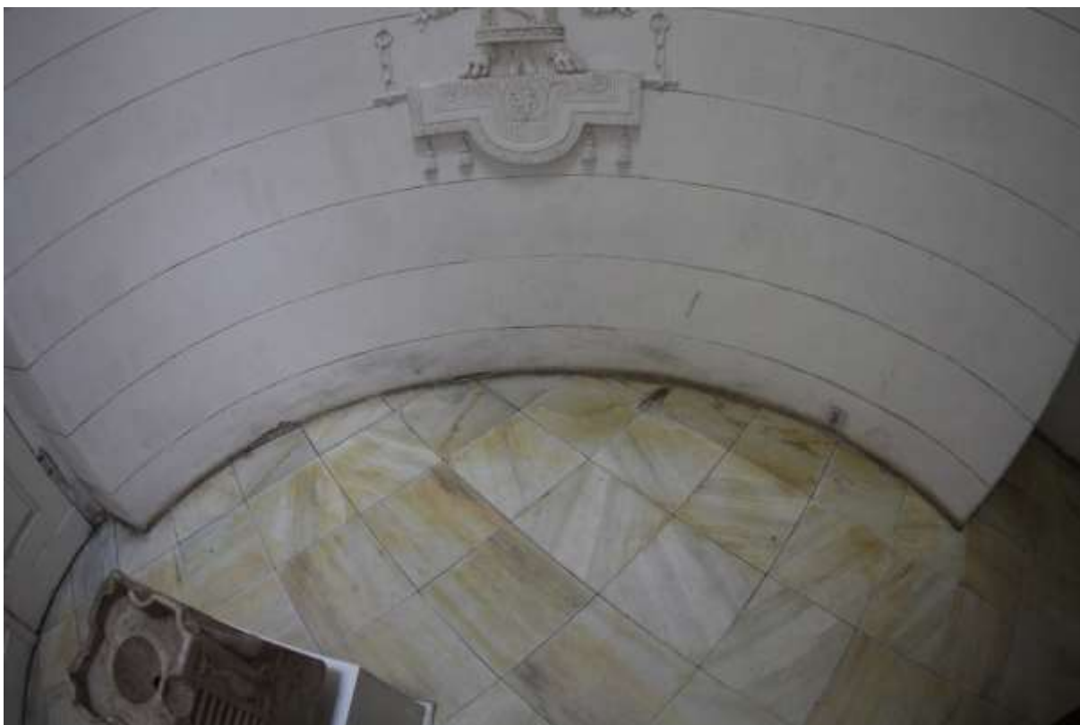
Fot. 118. Westybul. Posadzka. Przebarwienia marmurowych płyt podłogowych i zawilgocenie tynków w przyziemiu.
