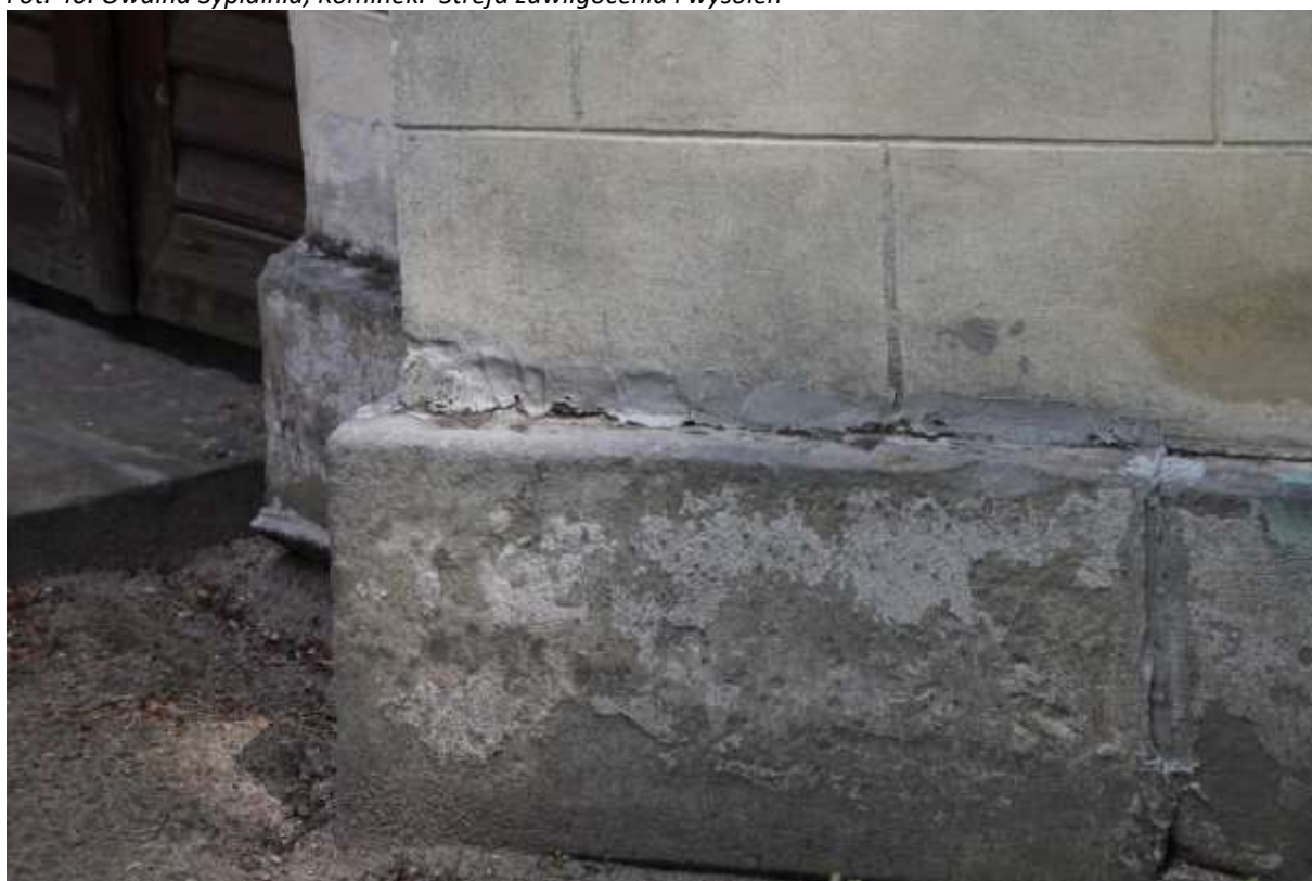
Fot. 41 Strona SE, Ściana kominkowa Sypialni Owalej od zewnątrz (por. z fot. wyżej). Kamienny cokół pokrywają pozostałości wtórnych przecierek. Uwagę zwracają cementowe, niestarannie założone spoiny.
