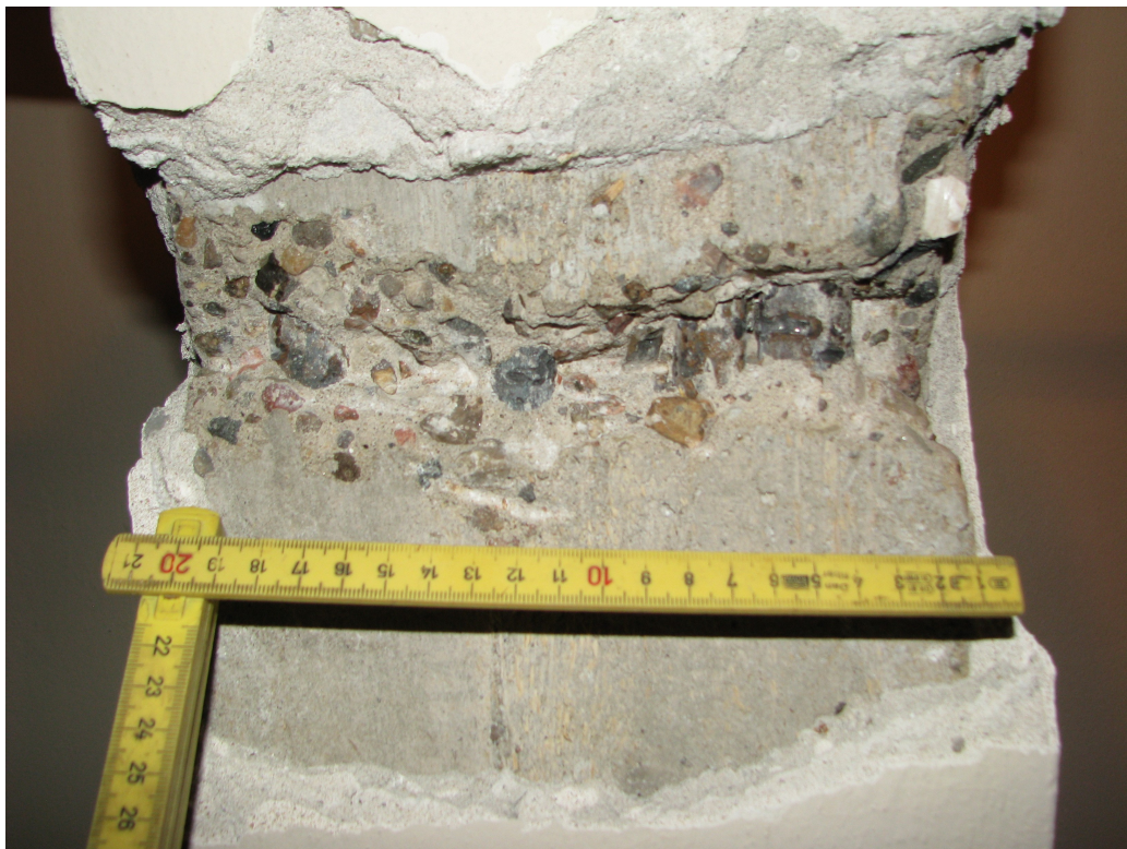
Rysunek 2: Odkrywka zbrojenia belki
